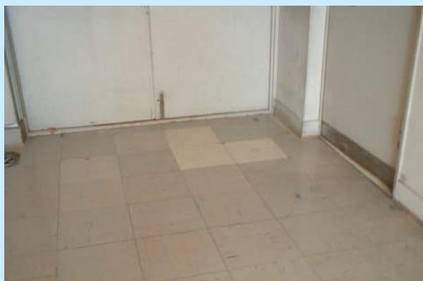
石綿含有ビニール床タイル（床）
