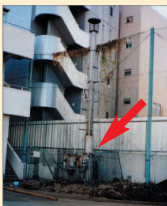
廃棄物焼却炉
