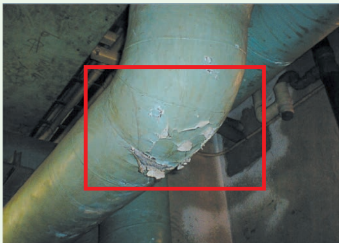
石綿含有保温材（配管曲がり部）
