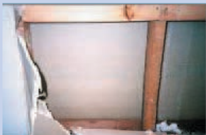
砒素・カドミ含有石膏ボード
