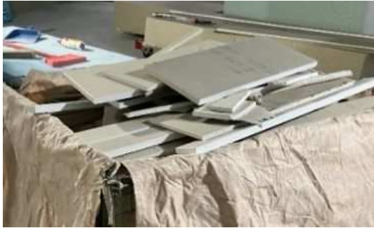
図 2 建設現場で発生する廃石膏ボード
