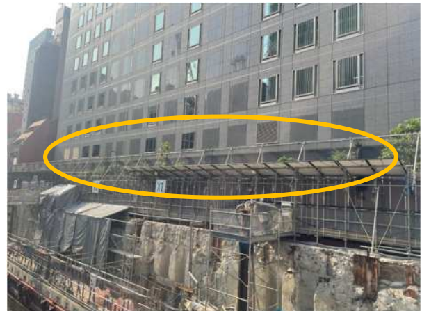
写真9. 太陽光パネルの設置状況
