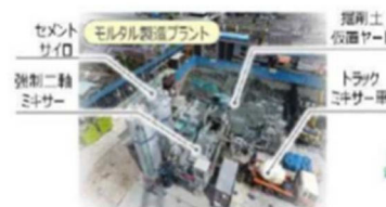
モルタル製造プラント
