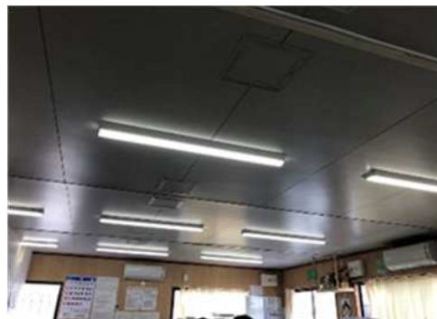
現場事務所内 LED 照明設置状況
