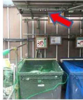
写真9 集積するヤードに設置 したセンサー
