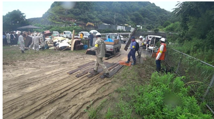
未舗装による泥濘状況
